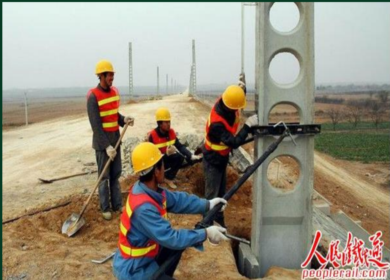
接触网支柱和基础
