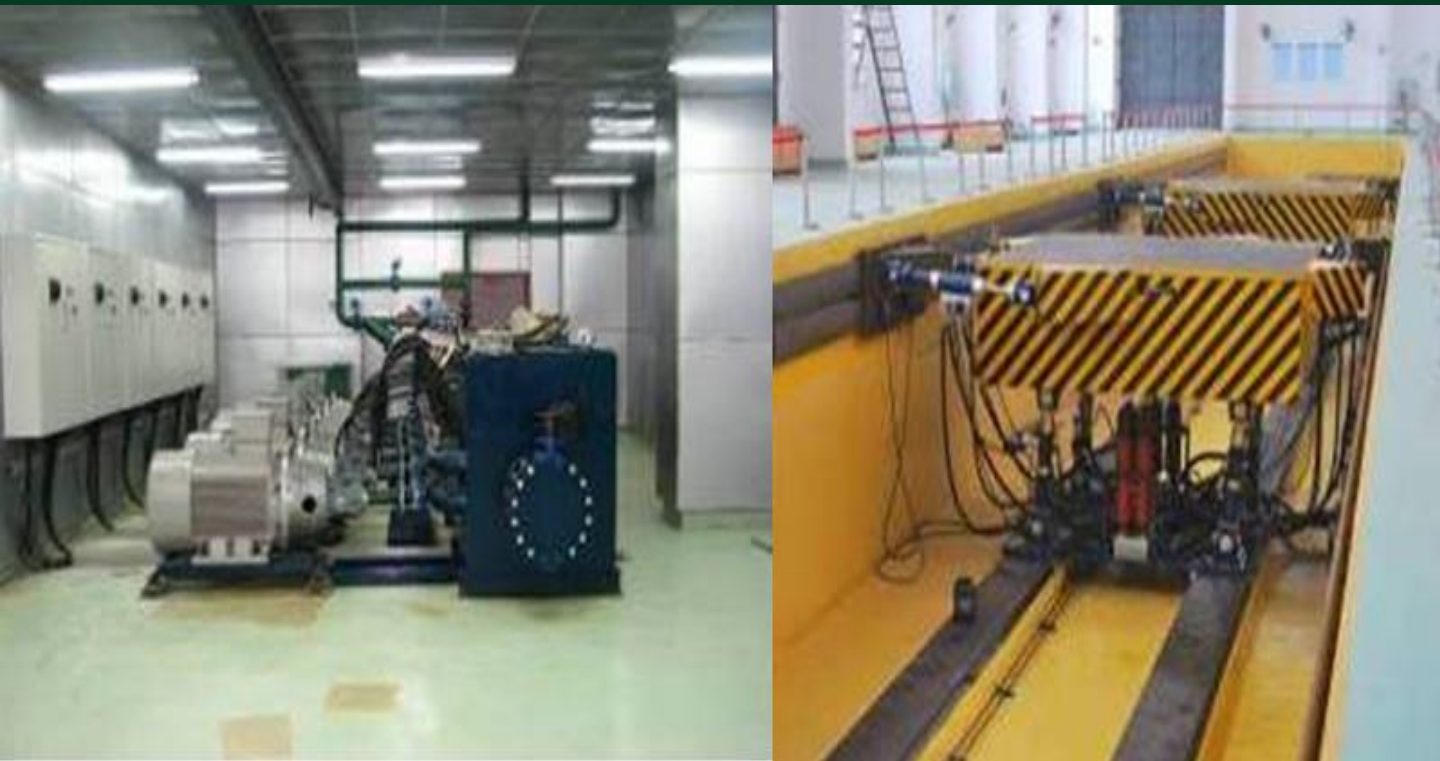
试验系统技术参数-高速铁路多功能振动台试验系统
