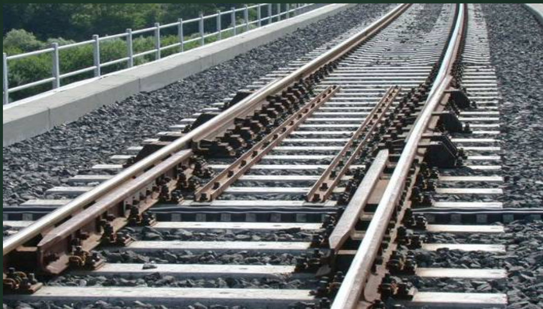
(b) 铺设在线路上的钢轨伸缩接头
